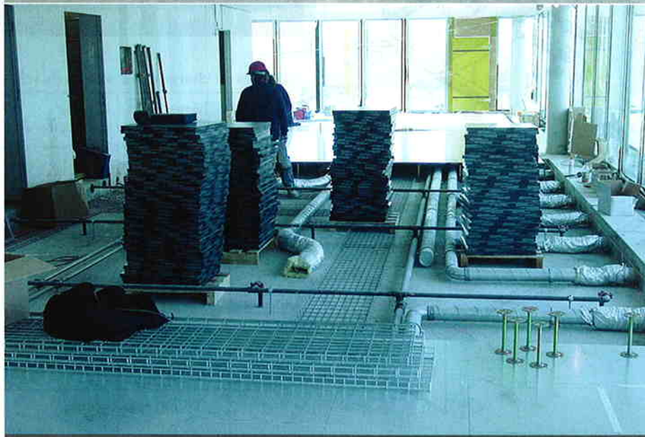
De haut en bas: vérins avec support et revêtement de sol. Face inférieure du plancher technique. Montage du plancher avec conduites d'alimentation de technique domestique.
