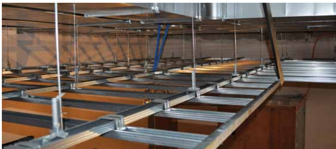
Les différents plafonds suspendus qui permettent le passage de la technique.
