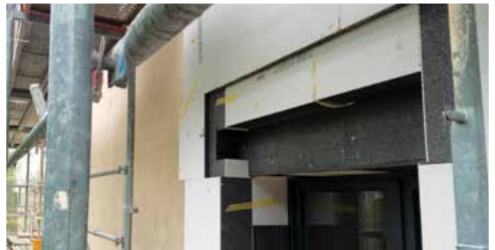
Avant la pose de la retombée créant la niche à store, les évidements pour le paquet de store ainsi que la niche pour la manivelle sont réalisés avec le plus grand soin.
