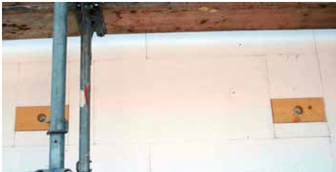
Ce détail n'est pas correct. Le bois n'est pas imputrescible et risque de moisir quand il se retrouve dans la zone de condensation entouré d'isolant.
