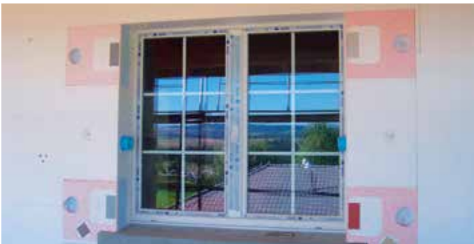
La pièce de fixation pour les volets est fixée mécaniquement à la façade et possède une zone renforcée en métal permettant au serrurier d'effectuer un filetage pour la fixation ainsi que pour l'arrêt bergère.
