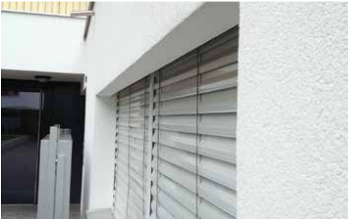
Le lambrequin cache le paquet de store et possède une finition identique à la façade crépie.
