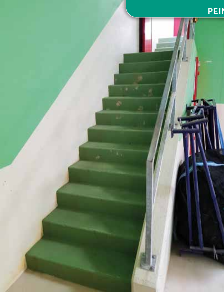
Sols en béton : les escaliers en milieu industriel sont fortement sollicités, mécaniquement et chimiquement.
