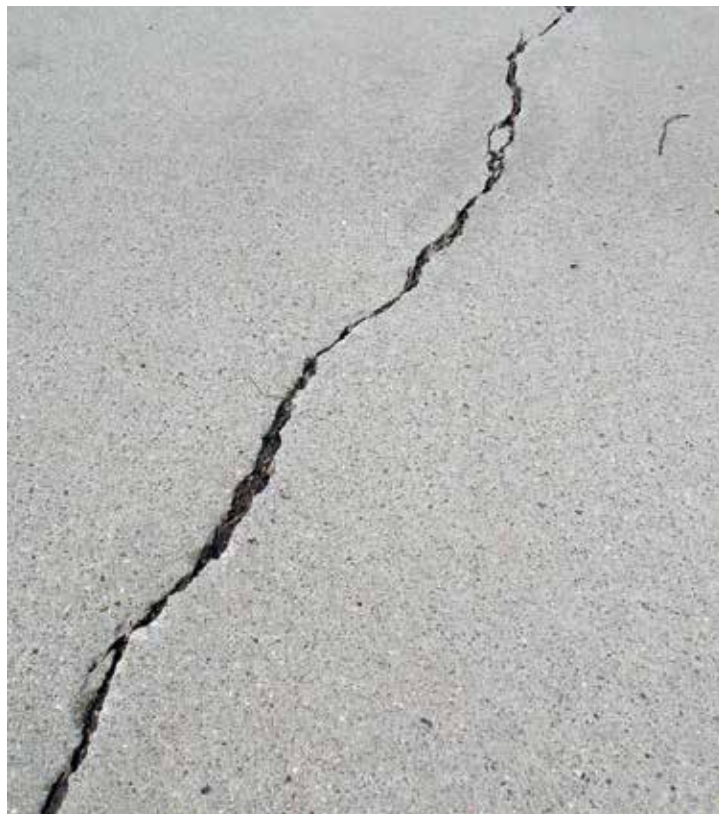
Les fissures au sol : une analyse des fonds est recommandée avant le traitement.
