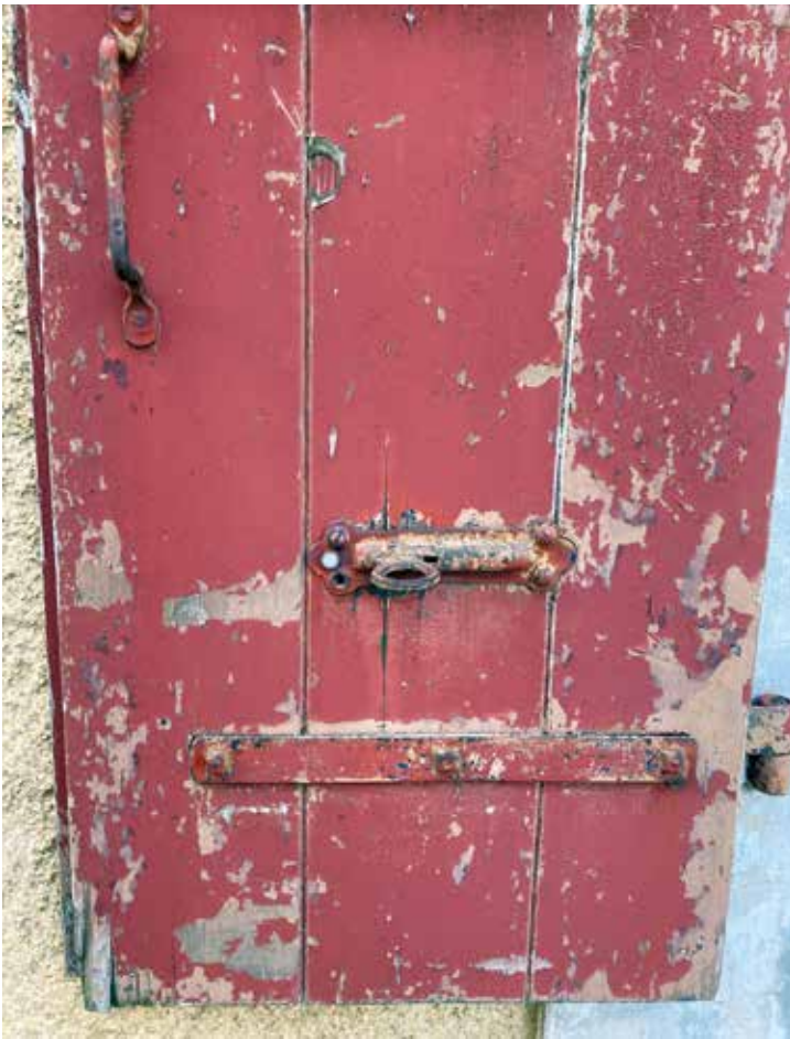
Avant rénovation : en très mauvais état
