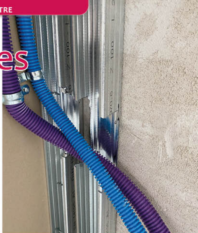
Affaiblissement non autorisé de la sous-construction par des conduites d'installation.
