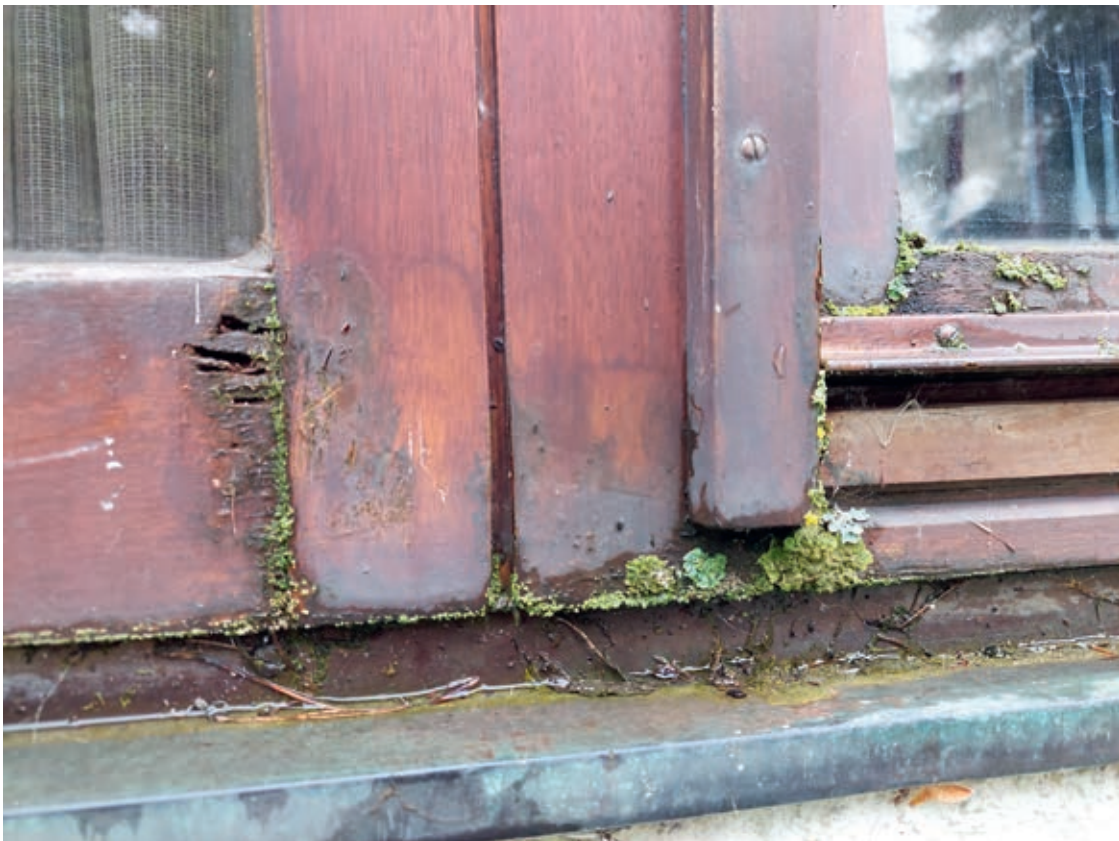
Quand la pourriture s'installe, il est souvent trop tard et le bois devra être changé.
