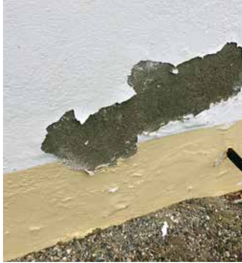
Les sels renforcent les infiltrations.
