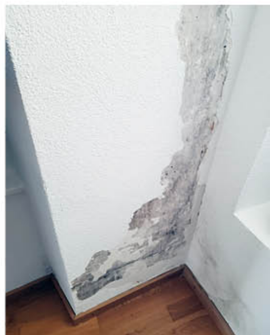
Les problèmes liés à l'humidité sont les plus courants.
